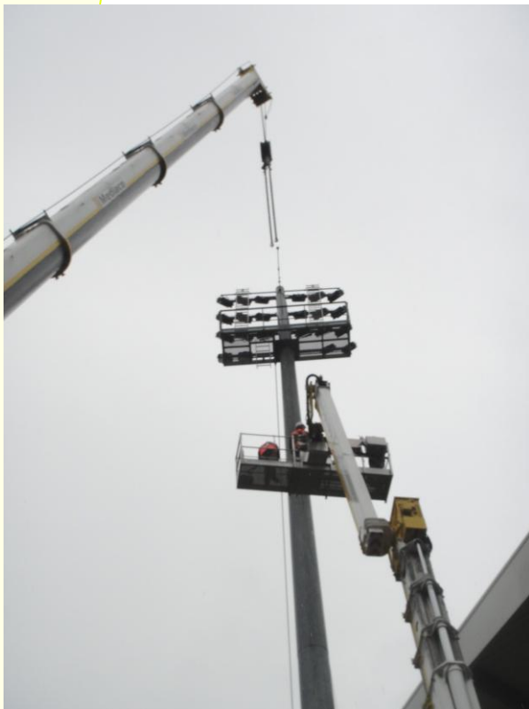
La nacelle de 52 m permet l'accès à la passerelle pour élinguage du mât
