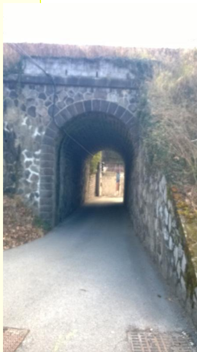
Passage tunnel à sécuriser
